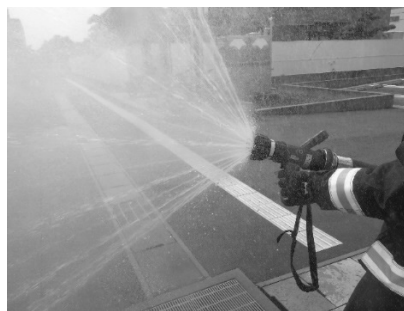
異物により噴霧放水不能 (写真4)
