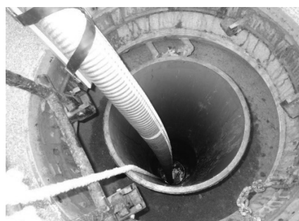
水が濁っている防火井戸
